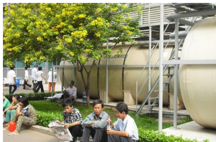
▲病院に設置された浄化槽
