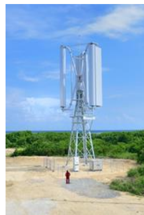
▲垂直軸型マグナス風力発電機 10kW試験機（沖縄県石垣市）
