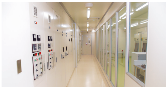
横浜細胞処理センター内部
