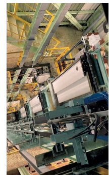
テストタワーで試験用に設置した船舶用エレベーター
